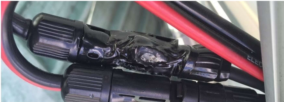
Figura 7 – Conector MC4 danificado por superaquecimento/arco elétrico
